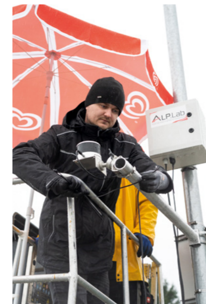
Abbildung 10: Verkabelung des Lidar-Sensors ©AustriaTech/Schallauer
